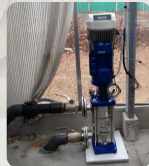
Pompe reliée au récupérateur d'eau sous les serres
