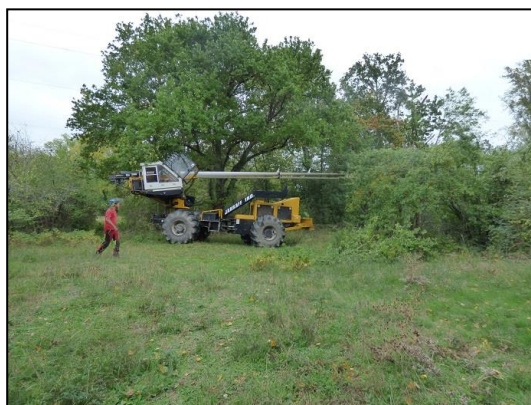
Coupe de la végétation sous les lignes HT à la Pointe de Courpain
