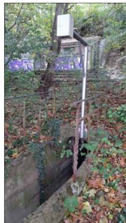
Capteur installé par O. Métropole pour mesurer les rejets inopinés du réseau d'assainissement
