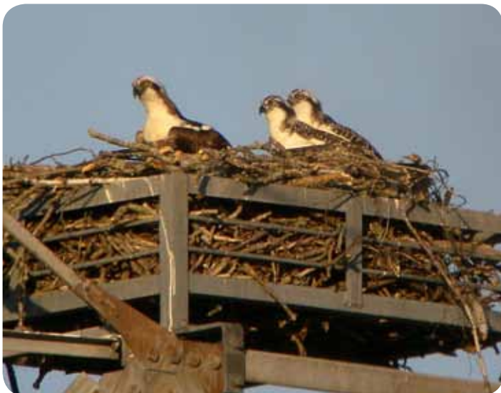
Pylône RTE Dampierre le 8 juillet 22 © RTE
