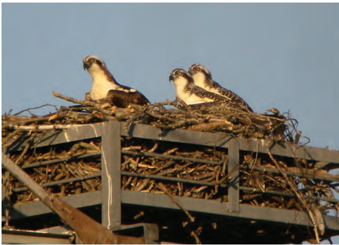
Pylone RTE Dampierre le 9 juillet 22
